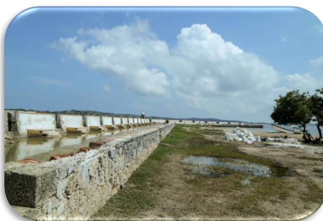
Problemas de inundación San José
